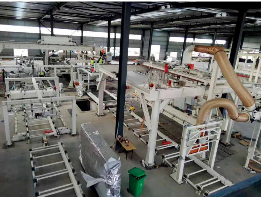
图9：在所有艾尔柯瑞特工厂中，只有球磨机、配料楼和切割线需要设备基础
