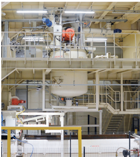
图5：搅拌机及其侧面法兰连接的高压清洗喷嘴
