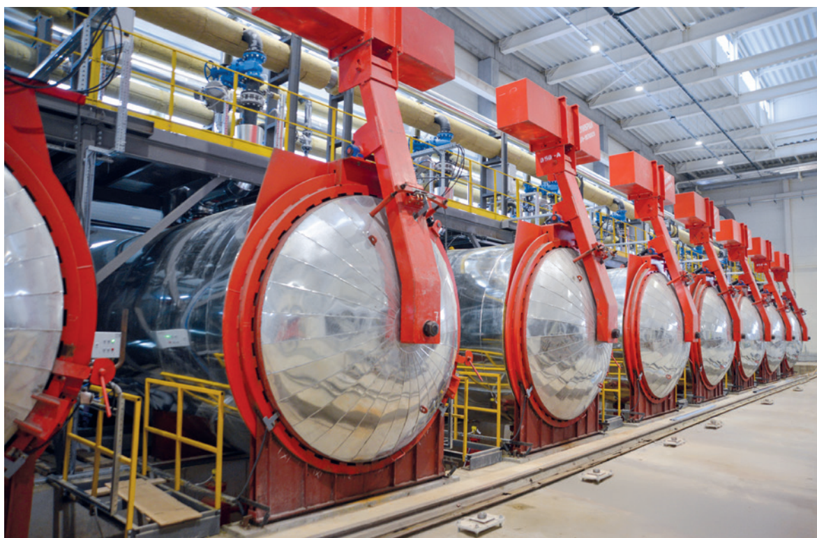
图7：蒸压系统，设计用于缩短循环时间并提升操作安全性
