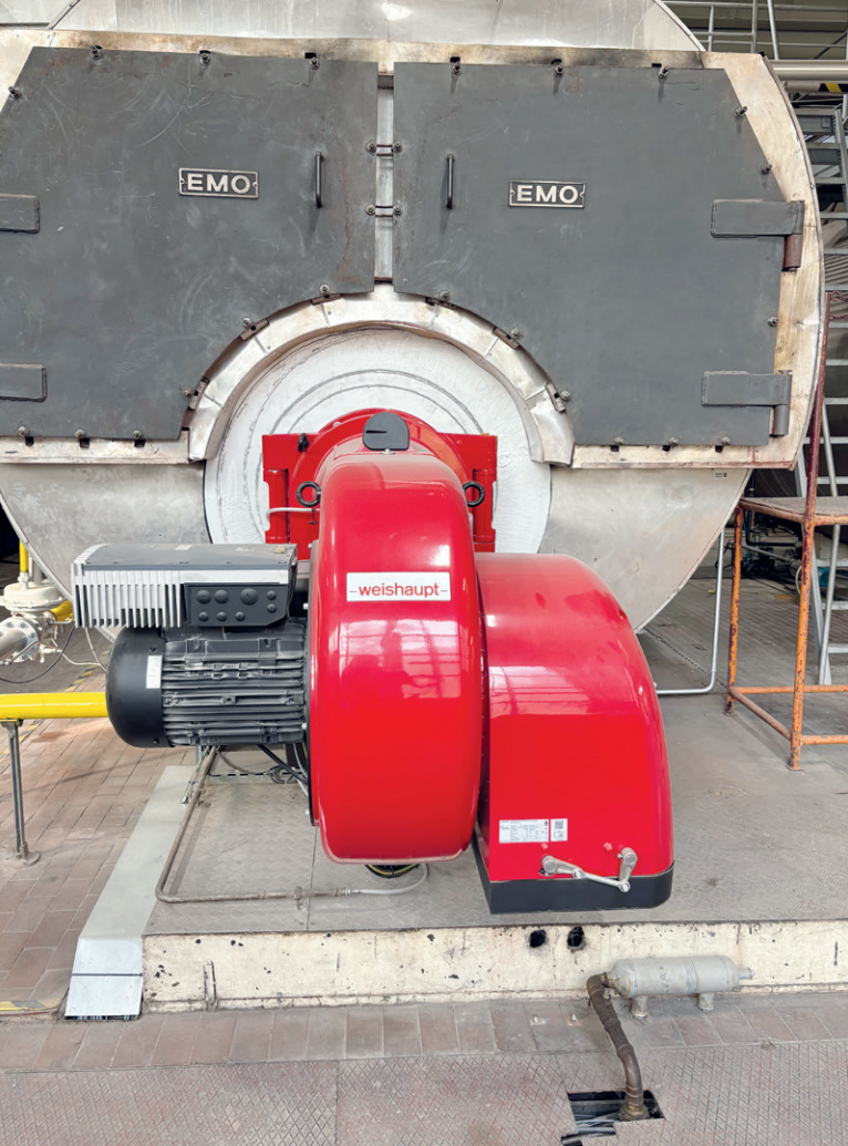
新型锅炉，其氮氧化物排放量比旧系统降低了 400% 以上
