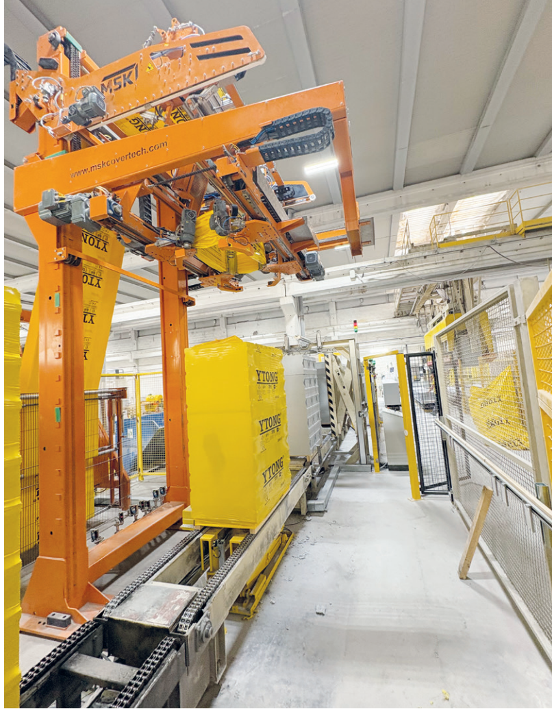
新型包装机提高了包装稳定性，降低了员工和客户面临的风险，体现了工厂在整个价值链上对安全的全面考量
