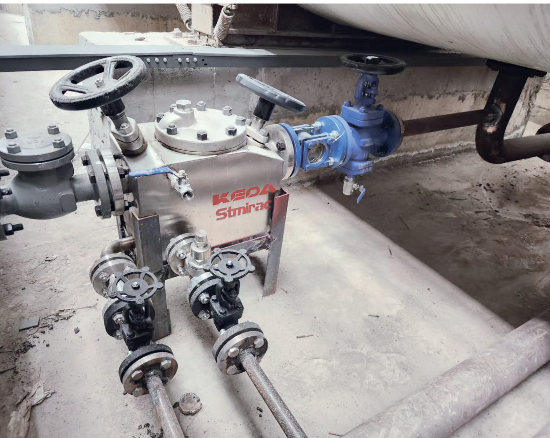
KEDA的蒸压釜排水系统 采用了全机械结构
