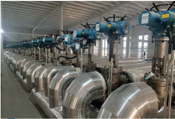
长兴YTONG工厂蒸压釜扩容、自动化配汽 [1].
