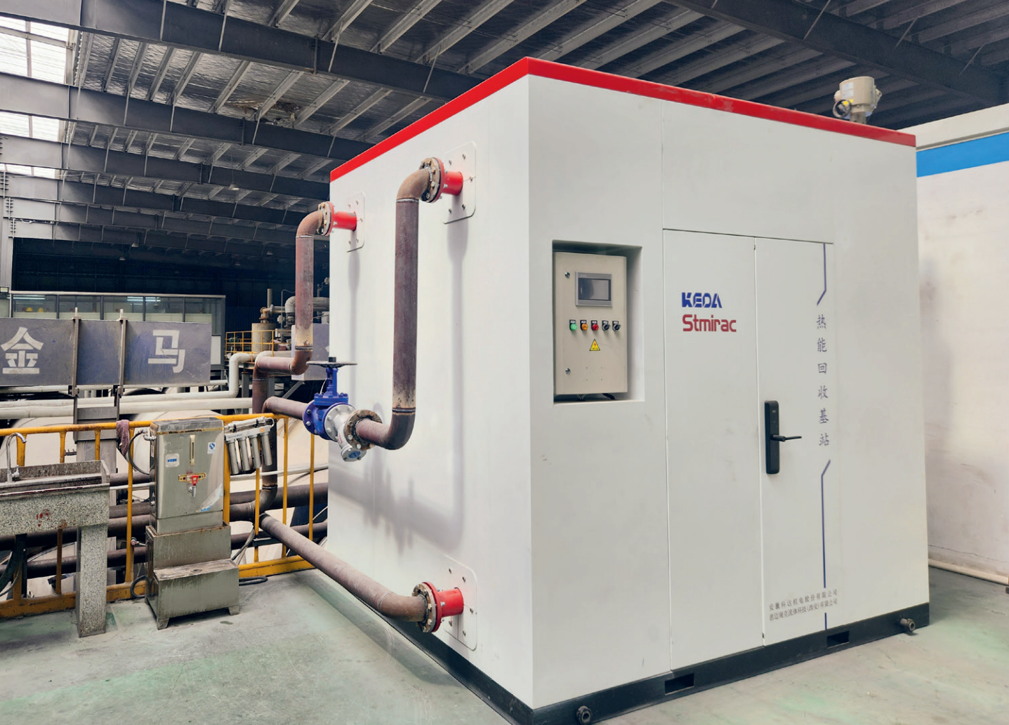
KEDA的余热回收系统已经在多个项目上投入使用
