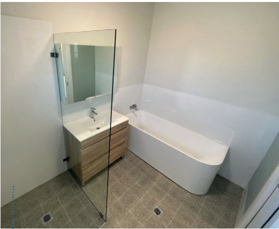
图11: 浴室舱在工厂安装，并完整地交付到现场。 (图片由建筑供应公司提供)
