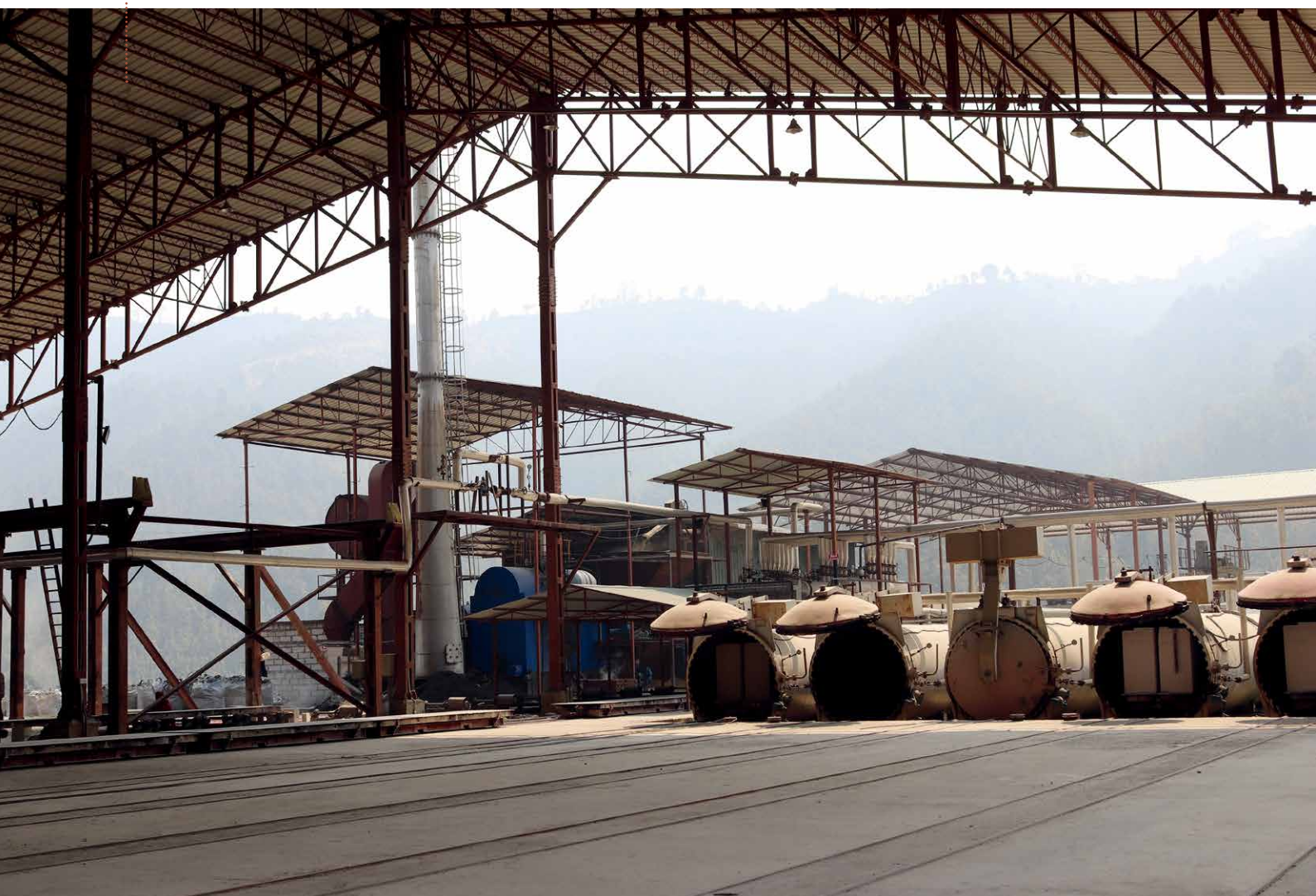
蒸汽锅炉及高压釜区
